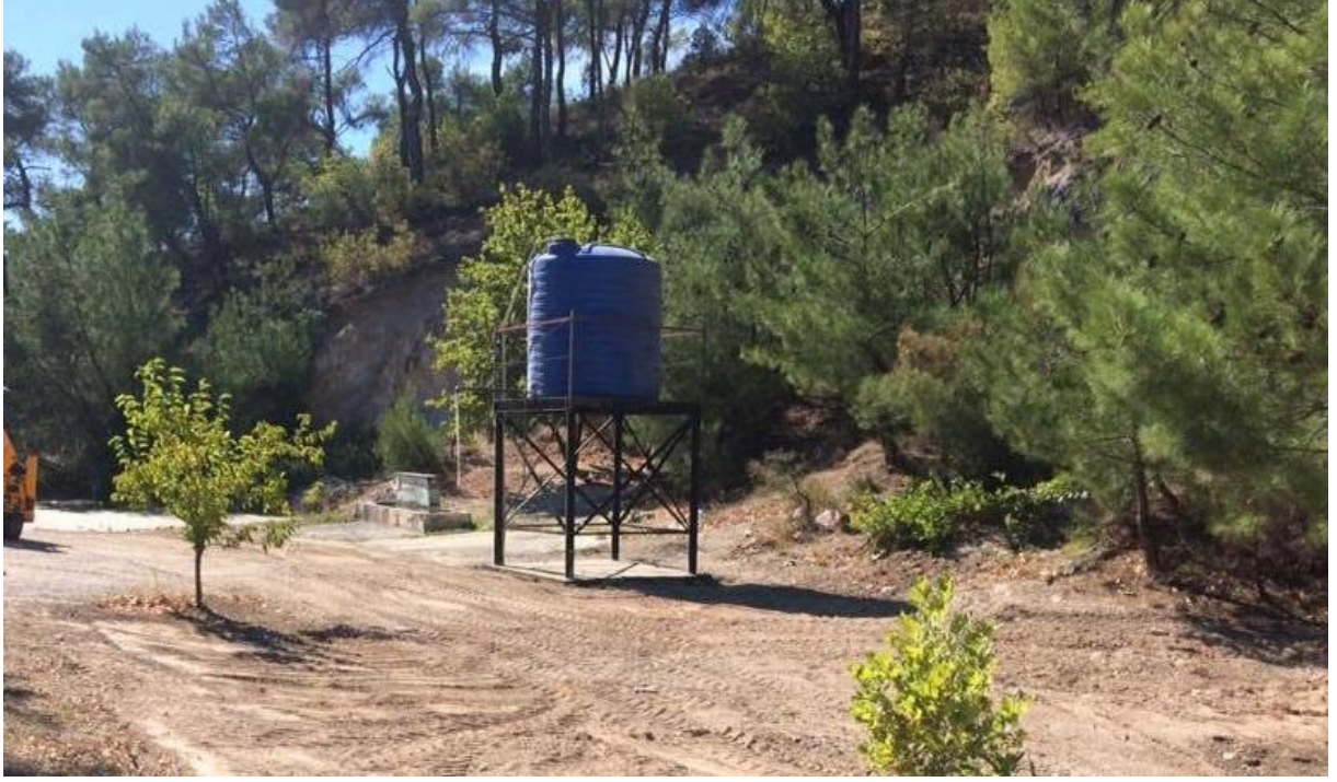
Şatırlar Mahallesi tarımsal sulama tesisi görünümü
